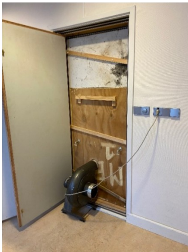
Ventilator in de jeugdzaal
